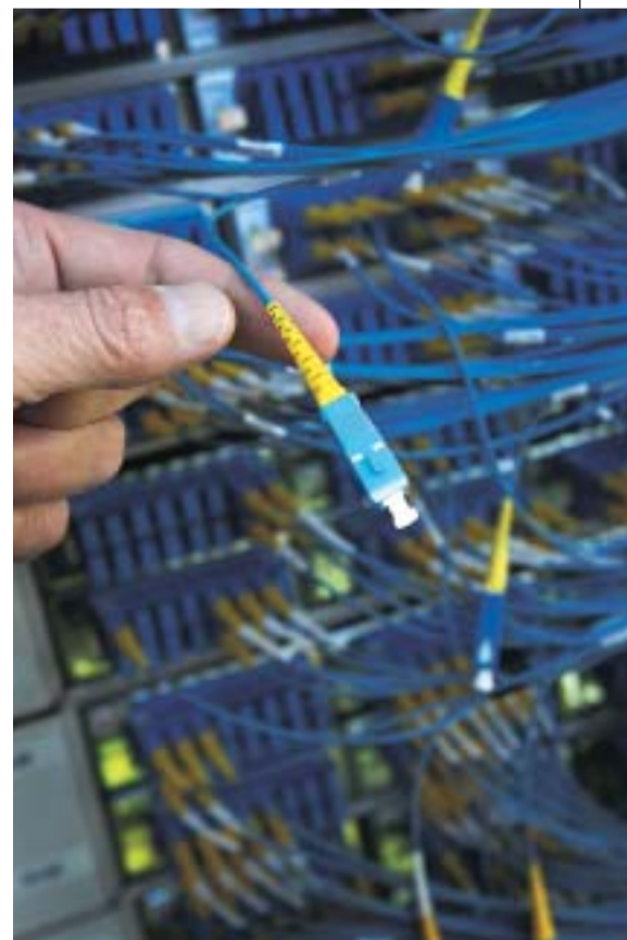
▲ En av alla 250 fiberanslutningar i tekniskåpet.
