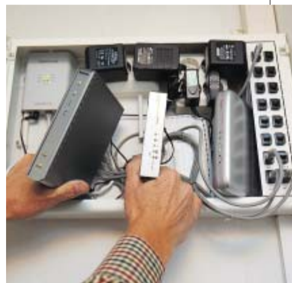
▲ Bredbandsskåpet i villan samlar bredbands- switchar för internet, telefon och tv.
